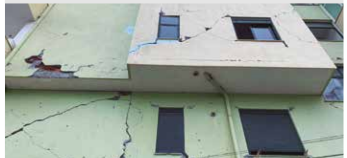
Edificio afectado por el terremoto en la zona de playa de Dürres (Albania)
